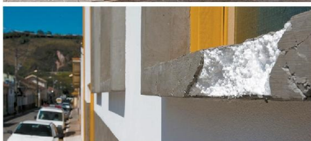
Detalhe do parapeito da janela, feito de isopor, destruído
